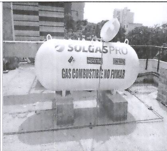
Tanque de gas de 500 lt.
