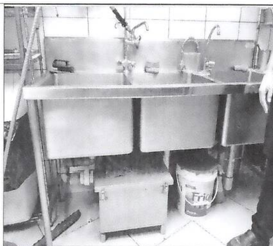
Trampa de grasa, en buen estado
