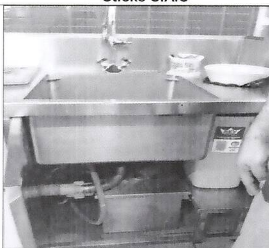
Trampa de grasa, en buen estado
