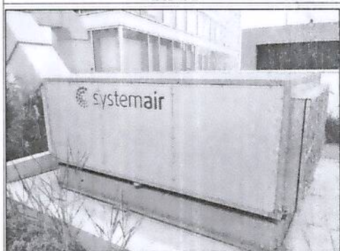
Sistema de depuración (Airlife)
