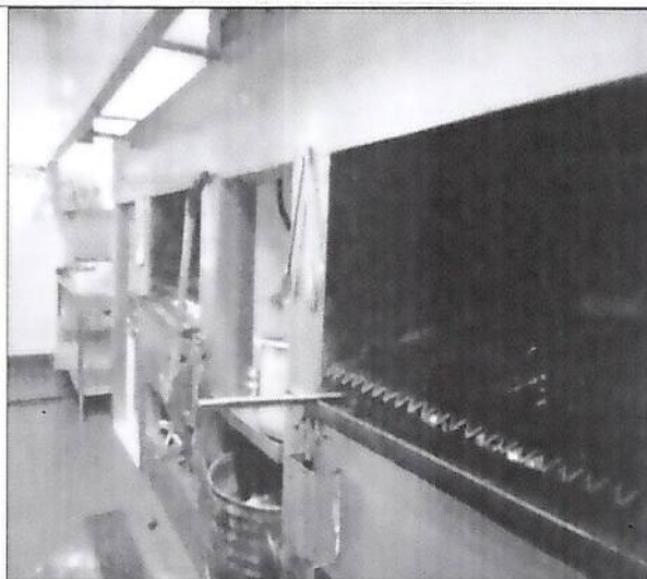
Sistema de extracción de humos y olores.
