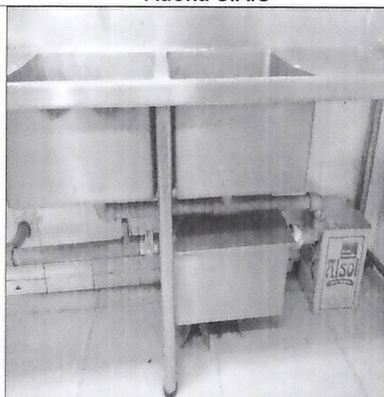
Trampa de grasa, en buen estado
